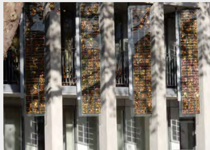
Abb. 6 Verschattungen von PV-Elementen sollten vermieden werden © Kingsgate House, London / P. Bonomo
